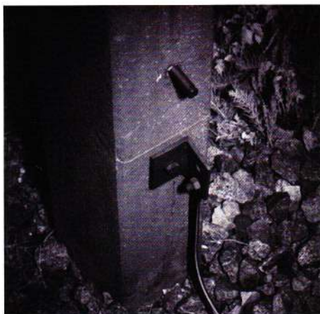
Infrarotaufnahme eines Oberleitungsmastes mit Mastbolzen und Erdungskabel
